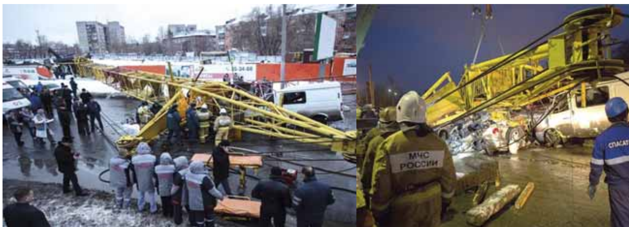
Рис. 51. Падение башенного крана КБ-403А на строительной площадке в г. Омске
